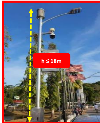
Rajah 1: Tiang lampu jalan yang diintegrasikan dengan sistem komunikasi dan CCTV
