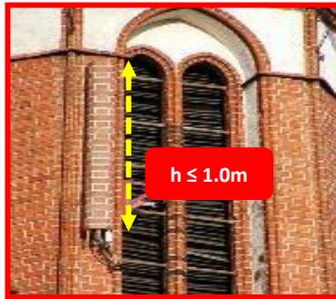
Rajah 5: Panel pemancar komunikasi yang dipasang pada dinding bangunan dan disesuaikan dengan warna fasad bangunan (diterapkan nilai estetik dengan teknik camouflage )
