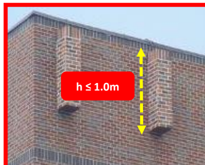
Rajah 3: Panel pemancar komunikasi yang dipasang pada dinding bangunan dan disesuaikan dengan warna fasad bangunan (diterapkan nilai estetik dengan teknik camouflage )
