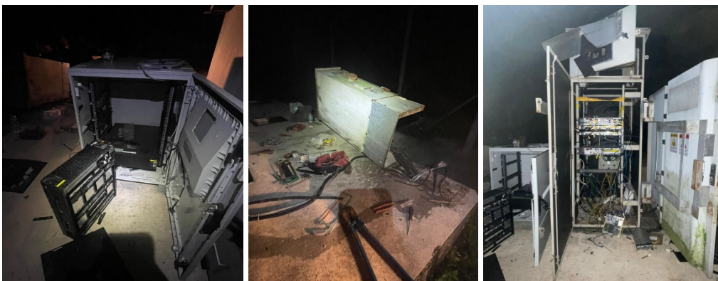
Kesan vandalisme ke atas menara komunikasi Kg. Gasak, Pekan, Pahang
